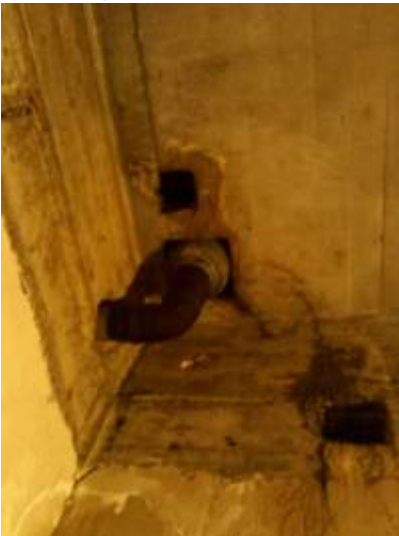
5. Hier wird es an mehreren Stellen unter der inneren Fensterbank nass. Die Fensterbauer haben hier auch noch das Plastikteil außen vergessen.
