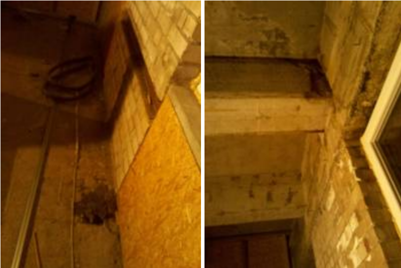
4. Hier tropft es aus dem Ausschnitt. Das Abflussrohr selbst scheint dicht zu sein.
