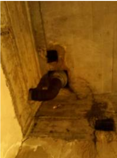
5. Hier wird es an mehreren Stellen unter der inneren Fensterbank nass. Die Fensterbauer haben hier auch noch das Plastikteil außen vergessen.
