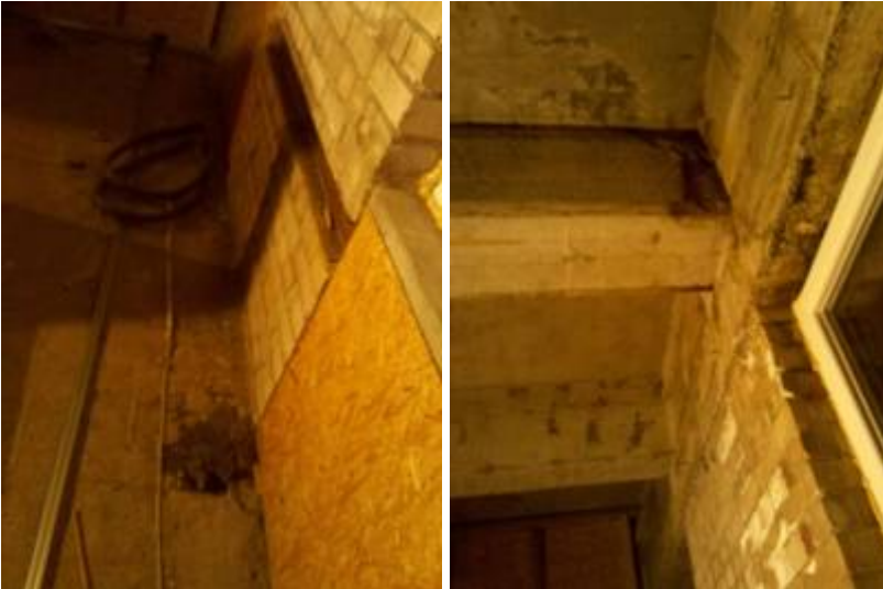
4. Hier tropft es aus dem Ausschnitt. Das Abflussrohr selbst scheint dicht zu sein.
