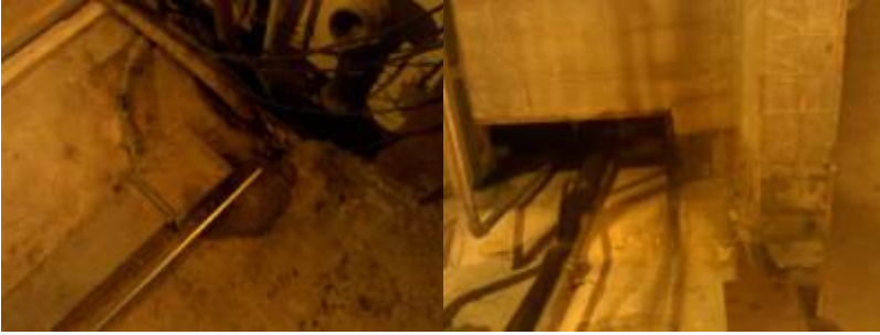
3. Hier tropft's vom Unterzug
